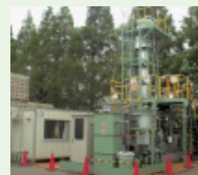
アサヒ飲料㈱柏工場の可動式テストプラント
